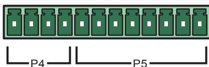
Рис. 4-7. Сухие контакты батареи
