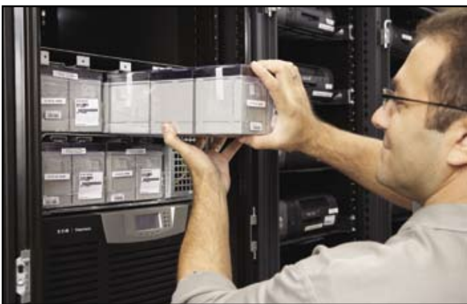
ИТ-персонал может легко производить замену аккумуляторных модулей.
